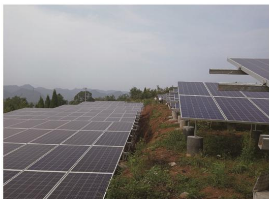
帮扶贫村光伏发电
